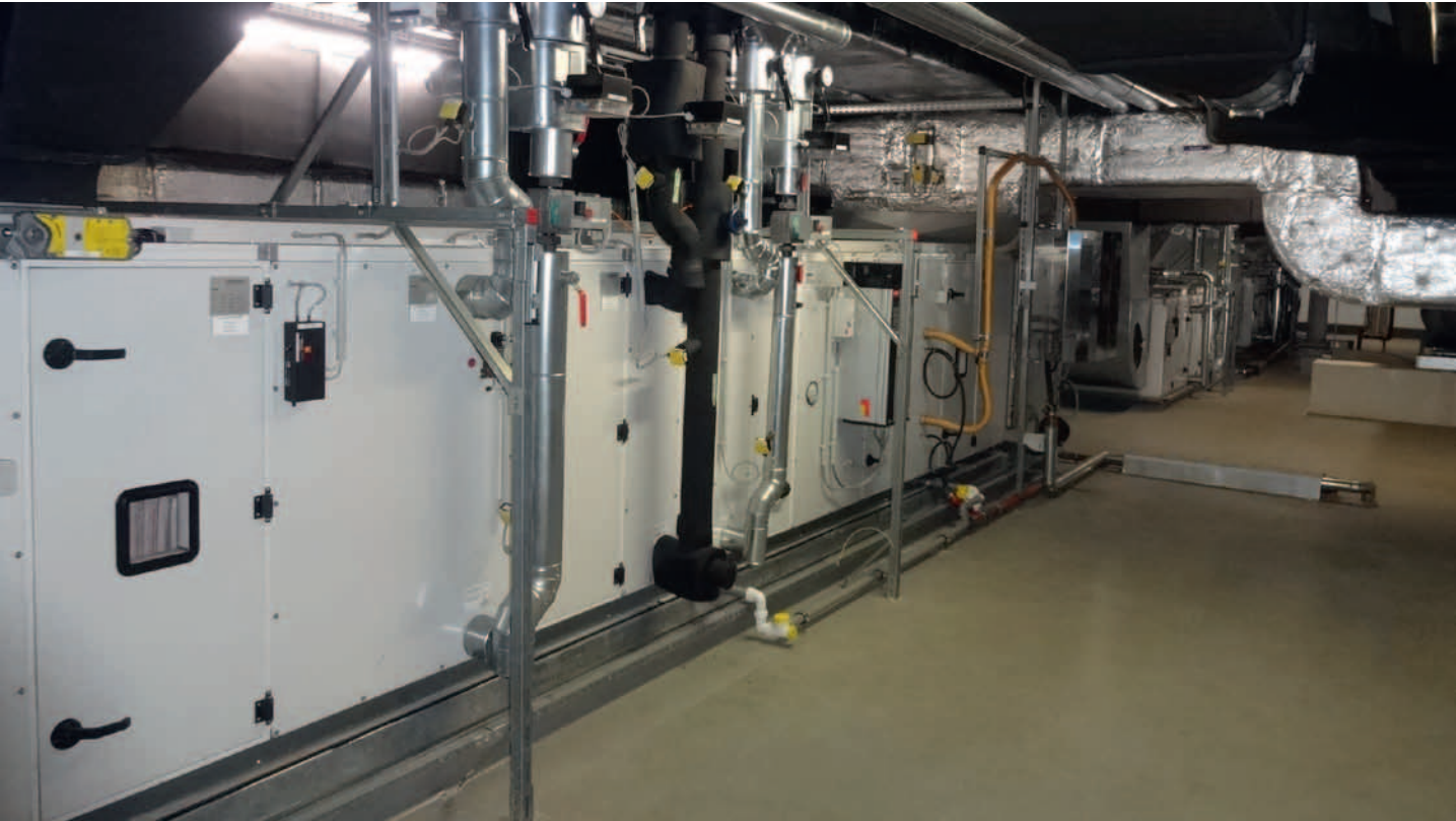
Abb.10: Lüftungszentrale in einem klassischen Nichtwohngebäude
